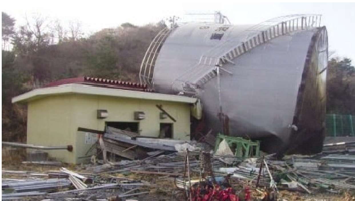
図 4.3-2 重油タンク倒壊状況
